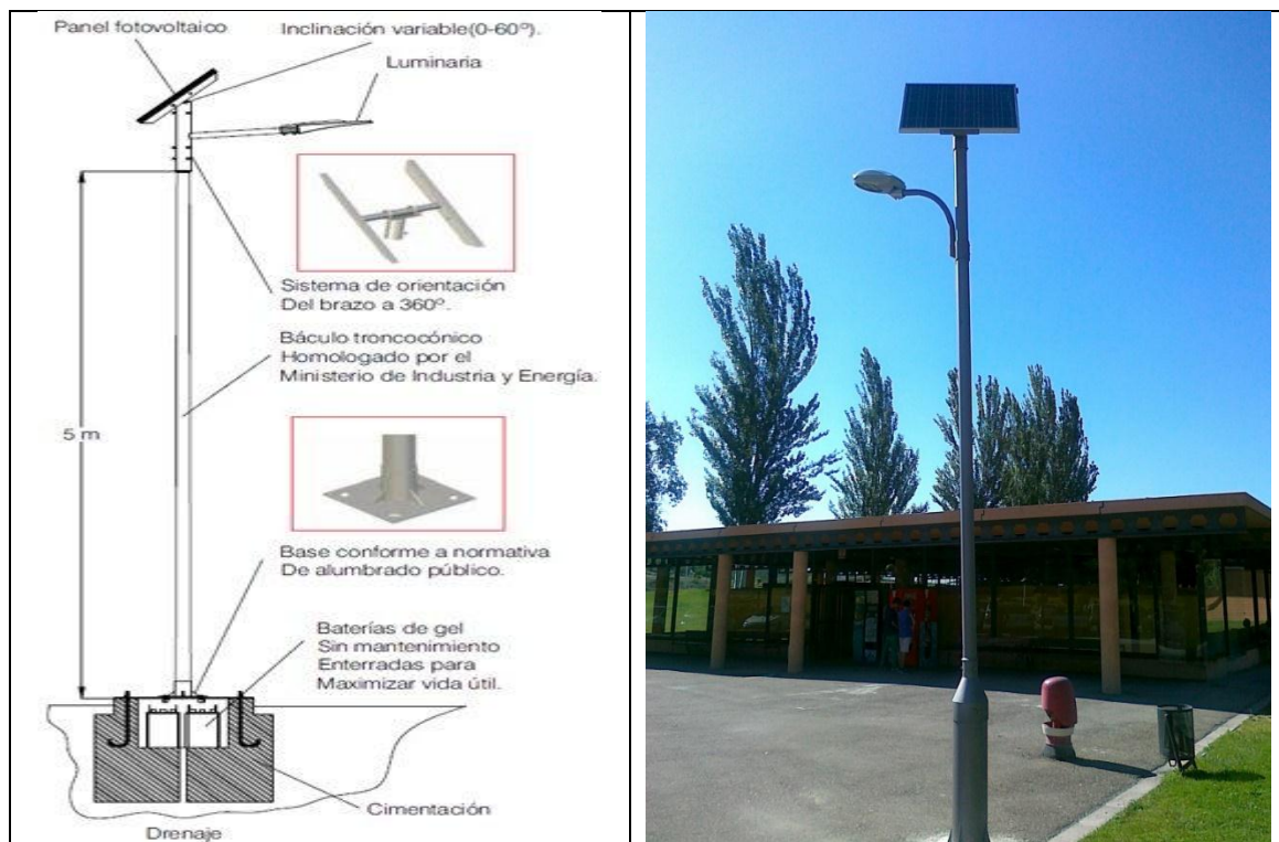
Figura 3. Sistema y farola solar en el complejo deportivo de “Las Fuentezuelas”.
